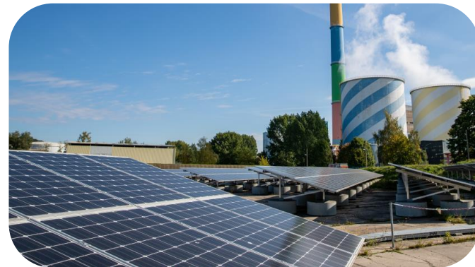
PV-Anlage am HKW Nord in Chemnitz
